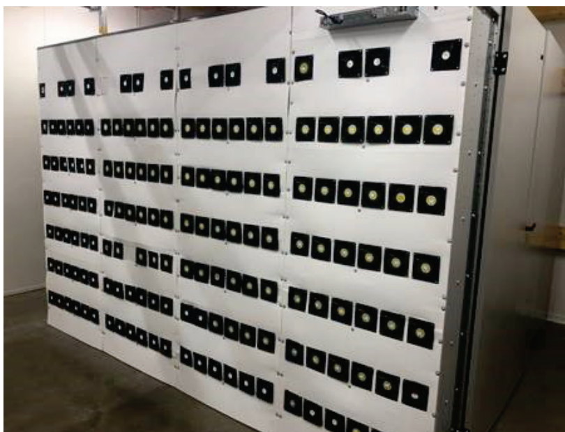
Figur 2: Datacenteranläggning för kryptovaluta med ASIC-riggar (Summers, 2021)
